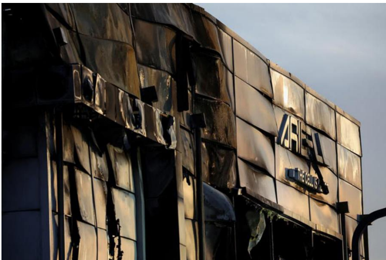
Kuva 2 Palon aiheuttamia vahinkoja akkutehtaalla.
